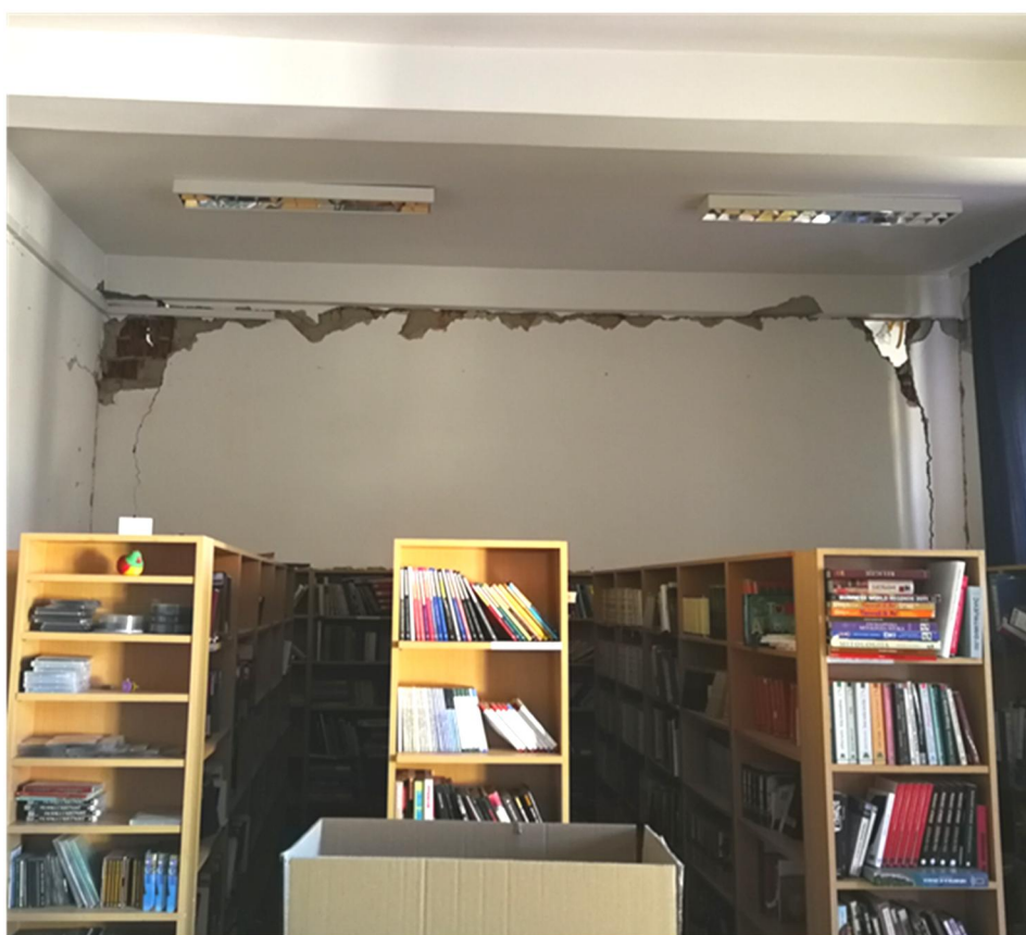
Rys. 7. Odspojenia na styku ściany wypełniającej i ramy żelbetowej oraz uszkodzenia narożników ściany (szkoła w Pertinji po trzęsieniu ziemi w grudniu 2020 roku).
