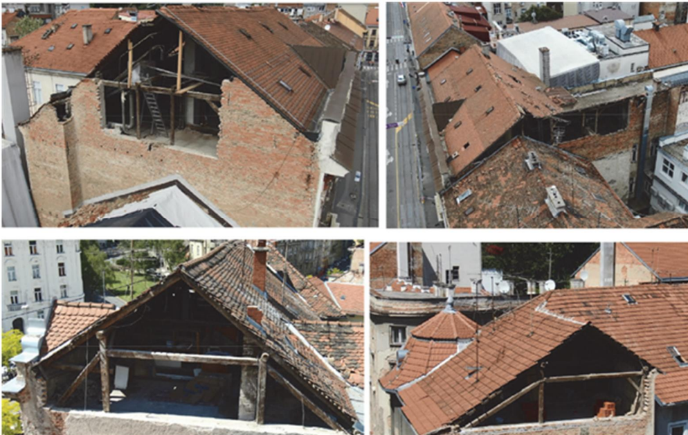
Rys. 4. Zniszczone ściany szczytowe (out-of-plane) po trzęsieniu ziemi w Zagrzebiu (marzec 2020), spowodowane uderzeniami elementów drewnianej więźby dachowej [2].
