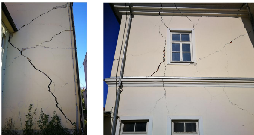
Rys. 2. Uszkodzenia ścian (in-plane) w centrum Petrinji (październik 2021).
