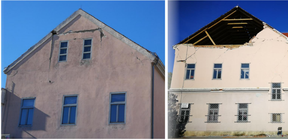
Rys. 3. Budynek zamkniętej szkoły w centrum Petrinji z uszkodzeniami ścian szczytowych typu out-of-plane (październik 2021).
